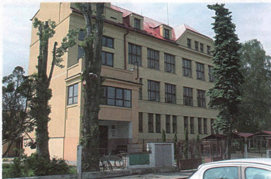
Okna v čachovické škole před rekonstrukcí.
