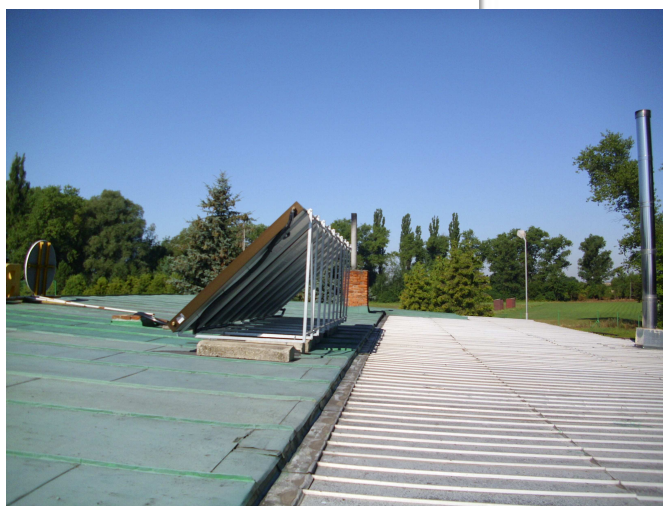
kolektory na střeše
